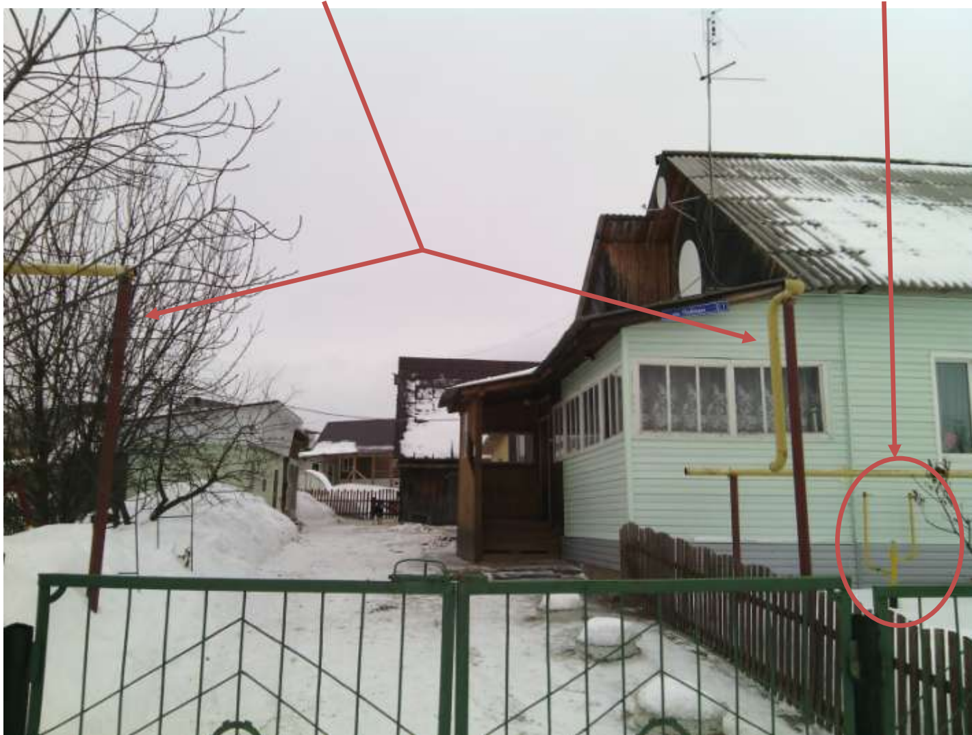
Рис. 11 Газоснабжение жилых домов в с. Нижние Муллы, д.Мураши, д. Ежи, д. Пищальниково, д. Усть-Тары. (I очередь) Пермский район
