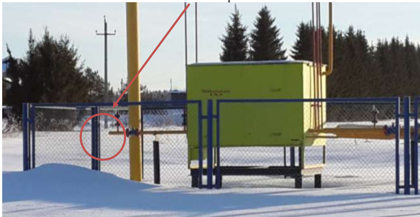
Рис. 7 Газопровод к объектам социально- культурного развития и жилому фонду пос. Дуброво Еловского района
